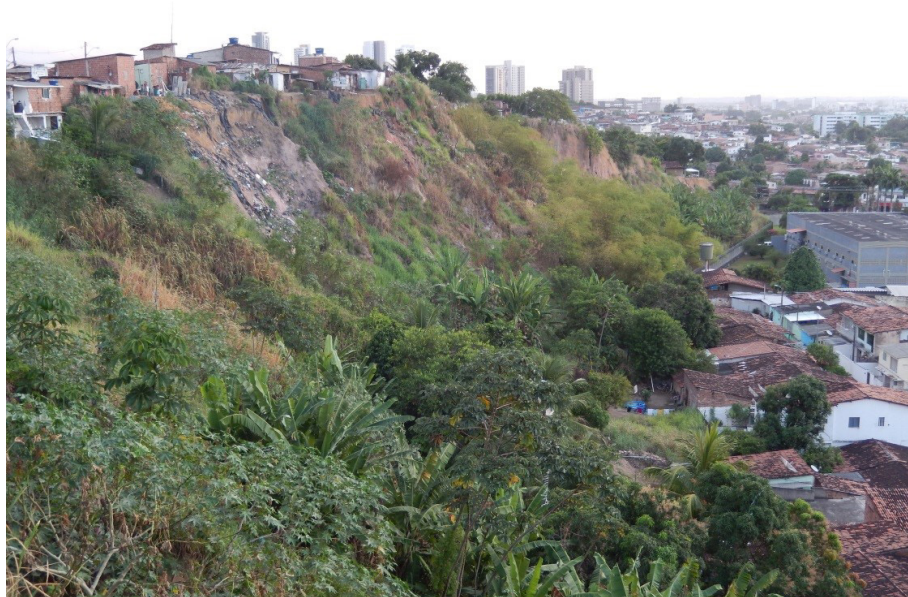
Figura 4 – Encosta com Trecho Superior em Processo de Dissecação, Apresentando Intensa Ocupação no Topo – Bairro da Macaxeira, Zona Norte da Cidade do Recife.
