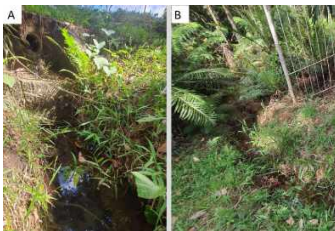
Figura 5 – UF23. 5A – Nascente difusa, em uma pequena depressão. Detalhe para a manilha a montante. Esta manilha drena águas pluviais da margem direita do canal principal. A água oriunda dessa manilha degrada a nascente, não só alterando as características físico-químicas da nascente, mas também sua morfologia. 5B – Vista para o canal que a nascente difusa forma antes de conectar ao canal principal.
