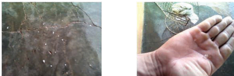
8 e 9 - Pedras de granizo no chão da casa com telhas quebradas e na mão do morador. Fonte: Pesquisa de campo (5 de janeiro de 2014, às 15h45min).
