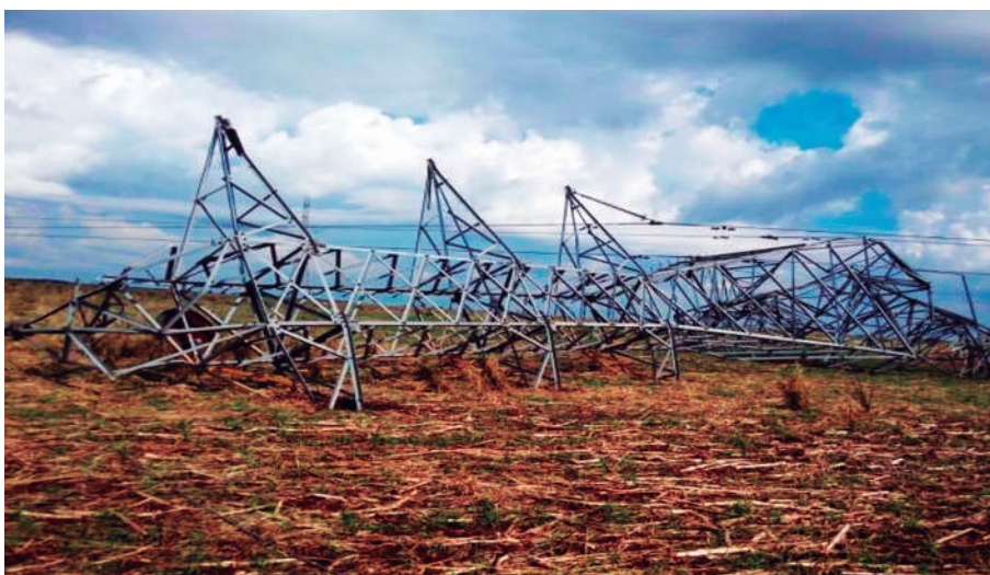
Figura 2 Torre de transmissão da Copel tombada na região de Cascavel-PR devido a ação de uma microexplosão no dia 12 de julho de 2016 às 23:30 UTC (Fonte: Copel GeT).
