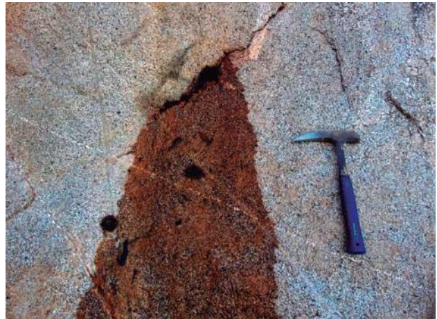
Figura 6 Saída de água por uma fratura de alívio no granito equigranular.
