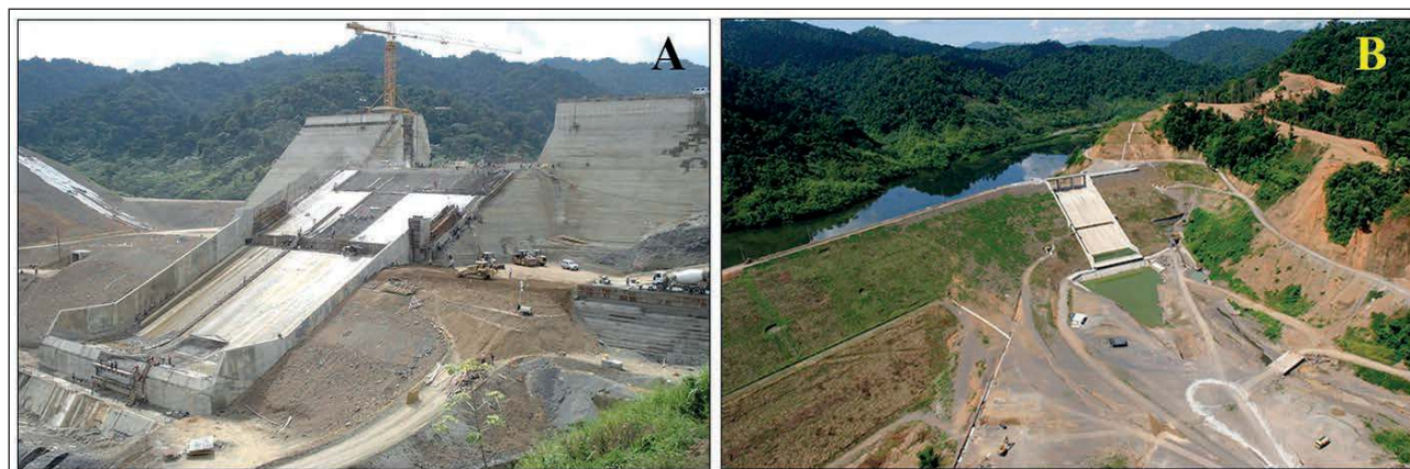
Figura 4 Imágenes de las (A) obras de construcción y del (B) diseño final de la nueva presa y del nuevo aliviadero.
