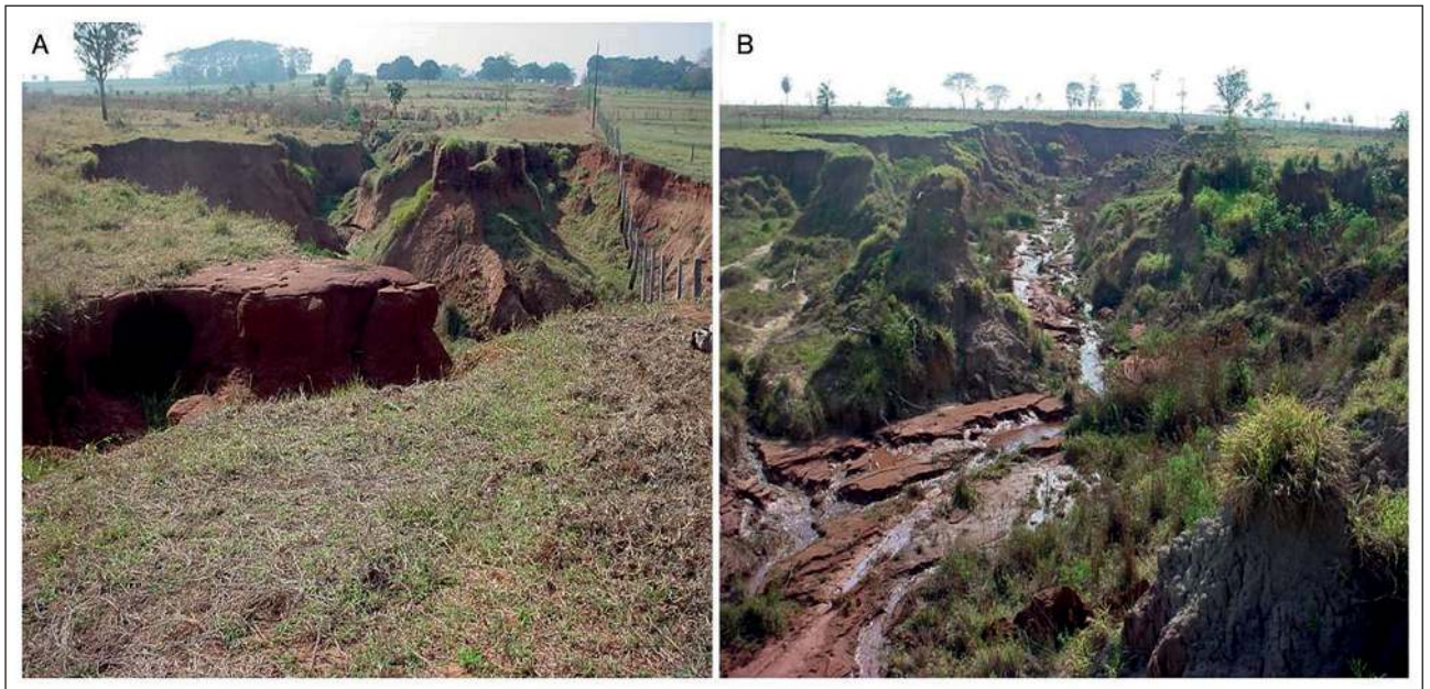
Figura 4 A Voçoroca no município de Deodópolis. Iniciada a partir da estrada vicinal, adentrando o terreno adjacente em nível mais baixo vê-se a estrada interrompida e a cerca em sua lateral suspensa, com aproximadamente 400 metros de extensão atinge o lençol freático desde sua cabeceira onde apresenta 6.5 metros de profundidade. B A jusante da primeira foto na qual a voçoroca se apresenta mais larga o lençol freático aflora em canais difusos.
