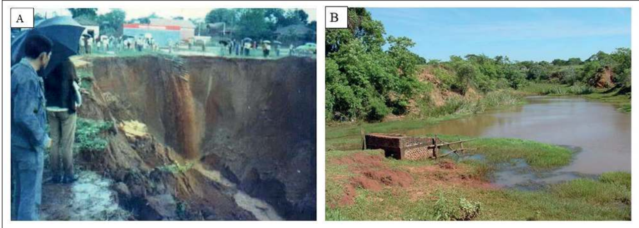
Figura 3 A Perímetro urbano do município de Glória de Dourados, início da década de 1970, a mais antiga feição erosiva da área em foco. Foto cedida pelo museu de Glória de Dourados. B A mesma voçoroca atualmente estabilizada com barragem e em processo de sedimentação.
