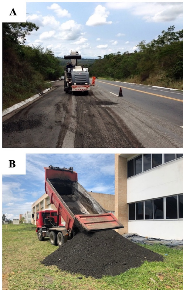
Figura 1 Geração e descarga do RAP: (A) operação de fresagem; (B) material fresado (RAP).
