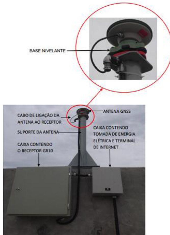
Figura 4 Estação de monitoramento contínuo da UHE Mauá (Muguio, 2012).
