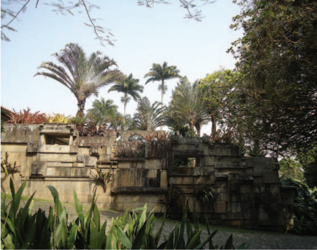
Figura 9 Casa principal - muro de arrimo do lago - lado externo (acervo SRBM/IPHAN/MinC em set. 2011).
