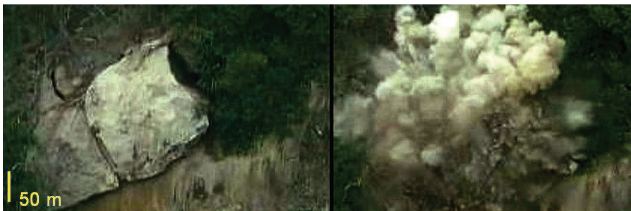
Figura 18 Desmonte do bloco na área do movimento de massa.
