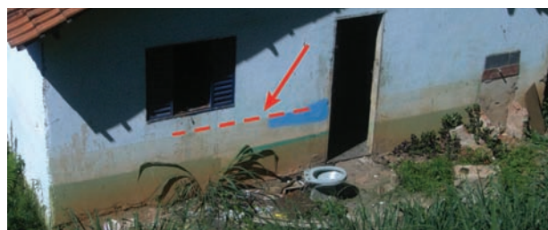
Figura 7 Marca do atingimento da água (linha vermelha) na parede de uma das 3 moradias situadas na margem direita do Ribeirão dos Moraes no Setor A5/S14/R2 – risco médio (ver Tabela 8). Habitação residencial de padrão construtivo médio (fundação e vigas de amarração incipientes), tipologia construtiva de boa resistência (alvenaria), infraestrutura sanitária do local considerada insuficiente, proximidade do talude de margem da drenagem.
