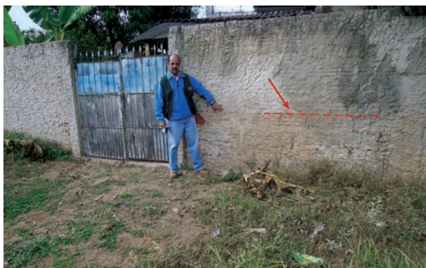
Figura 6 Marca do atingimento da água (linha vermelha) de evento de inundação ocorrido em Março 2009, na Avenida Itapitanga, Setor A8/S4/R3 – risco alto (ver Tabela 8).
