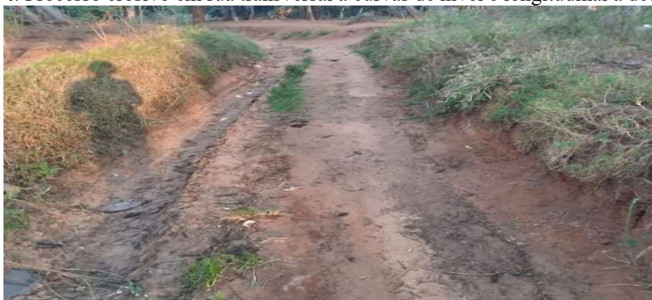
Figura 4. Processo erosivo em rua transversal a curvas de nível e longitudinal à declividade
