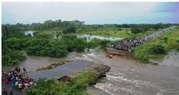
Figura 3. Estrada danificada pelo ciclone Gombe
