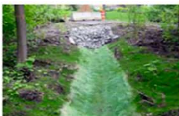
Poço de infiltração
