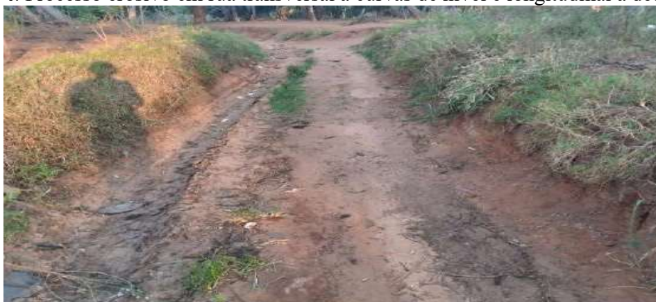
Figura 4. Processo erosivo em rua transversal a curvas de nível e longitudinal à declividade
