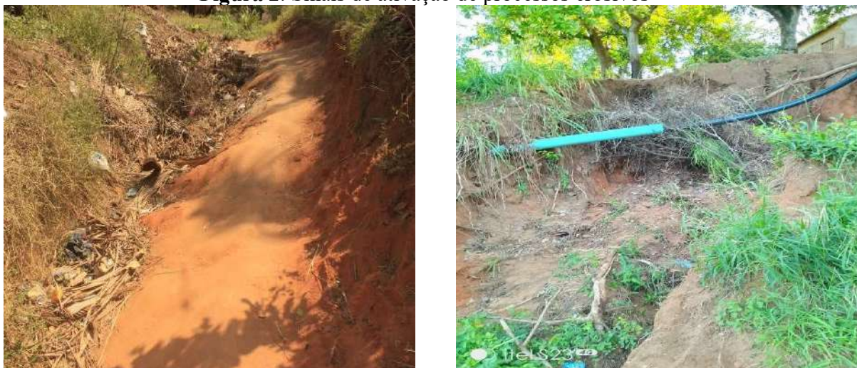
Figura 2. Sinais de ativação de processos erosivos
