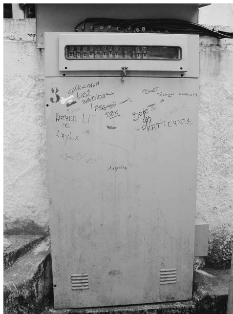
Foto 8 – Novo relógio de medição de consumo de energia elétrica, instalado pela Light em 2009
