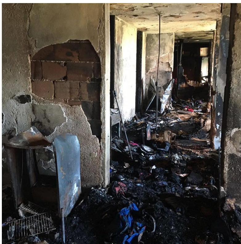
Registro do alojamento estudantil da UFRJ destruído após incêndio
