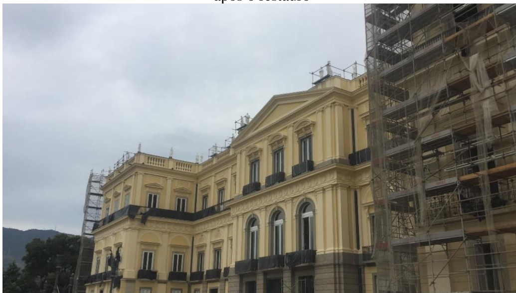
Figura 5 – Museu Nacional – Paço de São Cristóvão com fachadas parcialmente liberadas após o restauro
