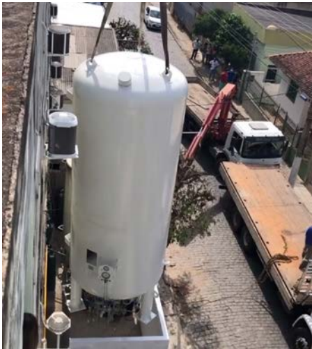
Il. 9: Instalação de novo cilindro de oxigênio no HSVP a partir de sua fachada voltada para a Avenida Fasbender, demandando interdição temporária da via.
