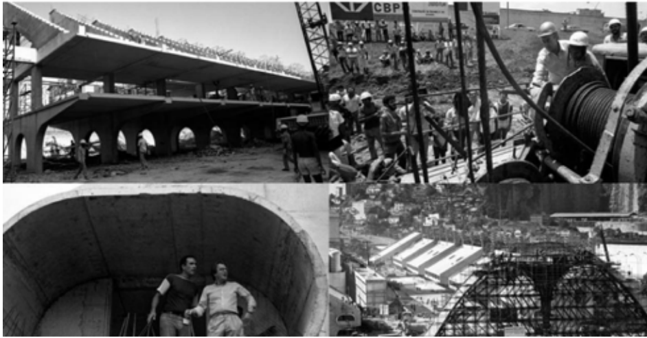
Obras de construção da Passarela do samba Darcy Ribeiro. Foto: AGÊNCIA O Globo, 1984.
