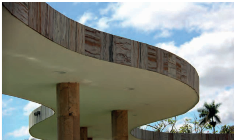
Figura 9. Detalhe da marquise da Casa do Baile (Fundação Municipal de Cultura, 2014, p. 178).
