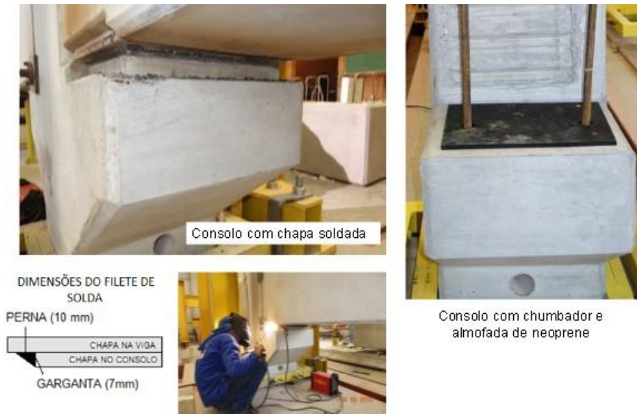
Figura 10: Execução da solda para os modelos CS e CSE e consolo com chumbador e neoprene para os modelos NCE e NC.
