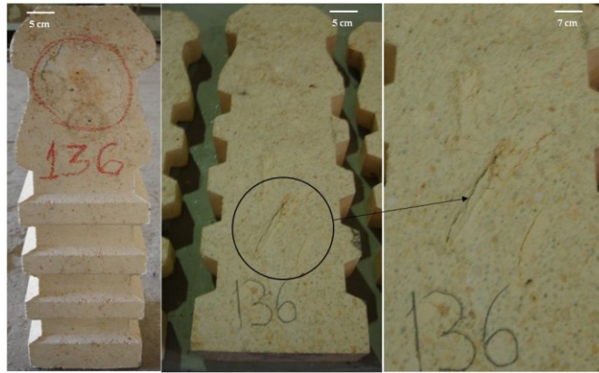
Figura 6: Âncora de teto 136 sob suspeita com presença de trincas internas.
