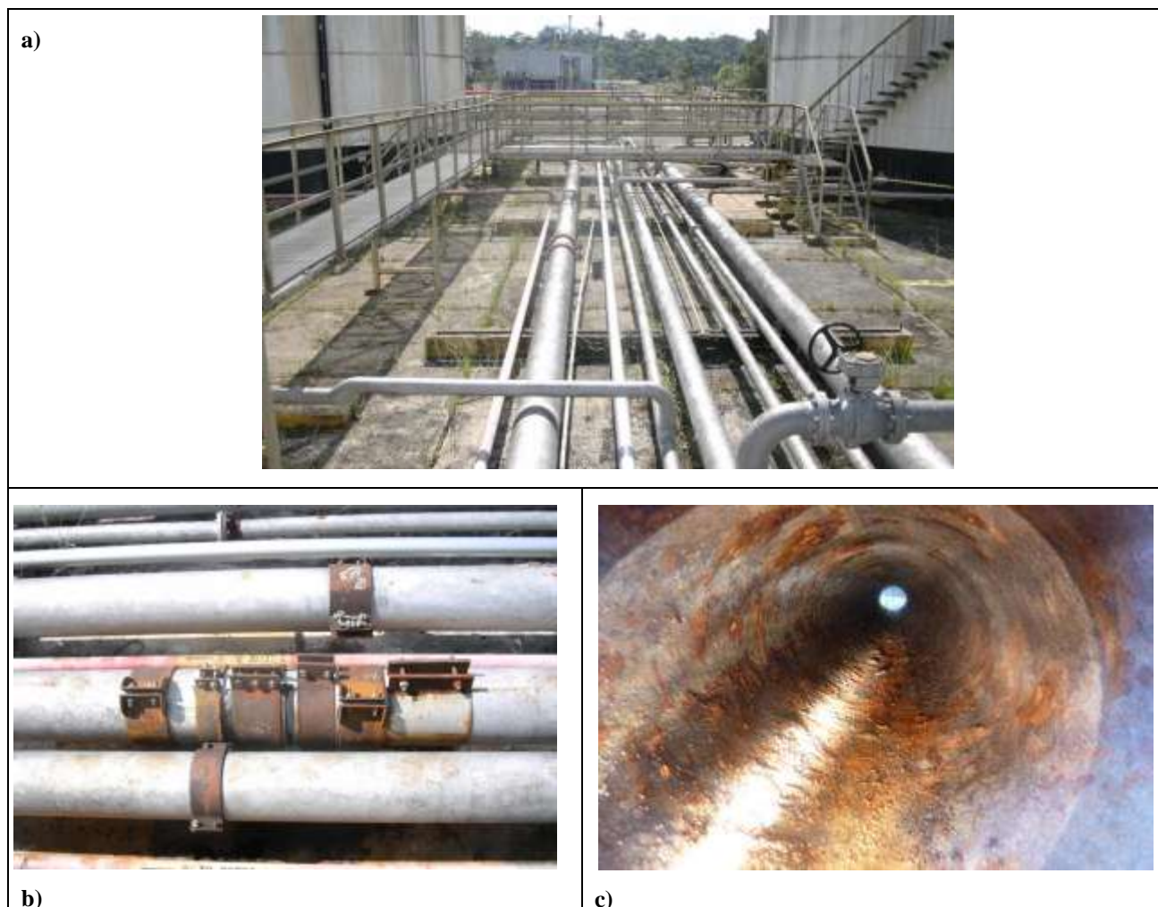
Figura 3: a) Imagem panorâmica das tubulações de parte do sistema de tubulações STU-85 responsável pela condução da água produzida. b) Imagem do trecho específico das tubulações de parte do sistema de tubulações STU-85 responsável pela condução da água produzida. c) Imagem da geratriz interna no trecho reto da tubulação pertencente ao sistema de tubulações STU-85 responsável pela condução da água produzida.
