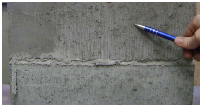
Figura 2: Prisma com ruptura por esmagamento da junta.
