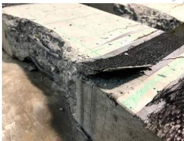
Figura 13: Descolamento do reforço de CFRP.
